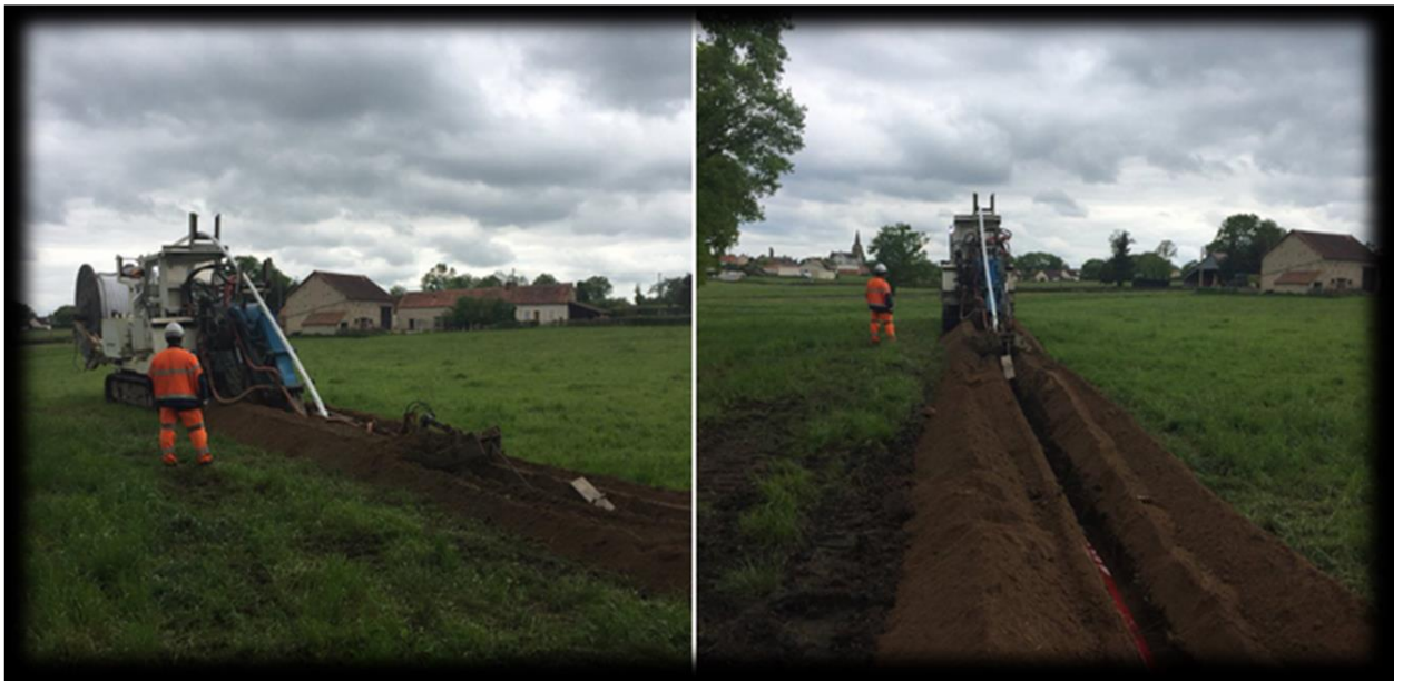
Exemple de chantier d'enfouissement d'un réseau électrique en terres agricoles (source : Cegelec infra)
